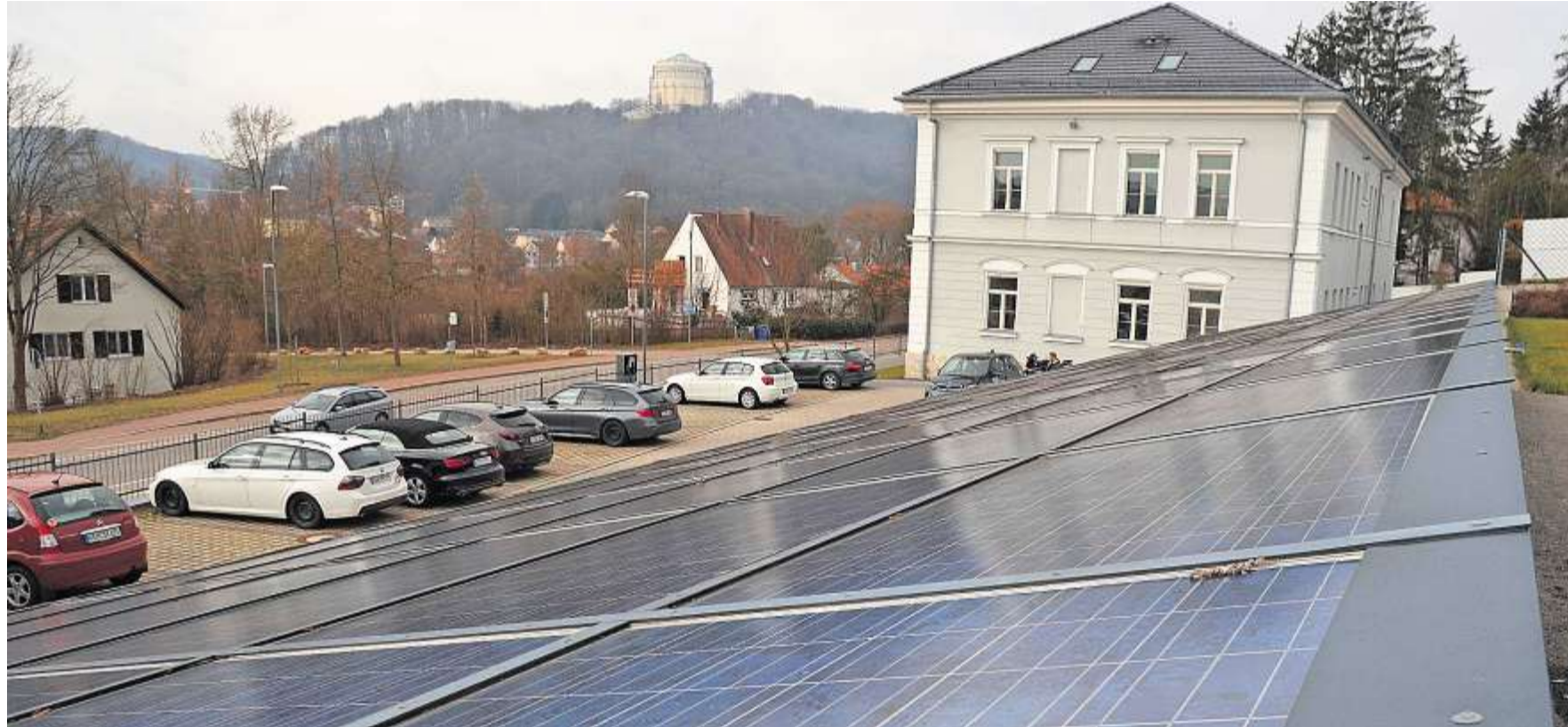
Mit Hilfe einer architektonisch gestalteten Photovoltaikanlage können die Firmen im ehemaligen Kelheimer Krankenhaus die Hälfte ihres Strombedarfs selbst erwirtschaften.
